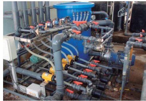
La inyección de fertilizante en el sistema de riego permite asegurar una nutrición exitosa. Intagri.
