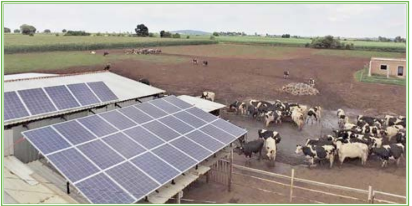
LOS PANELES reducen el uso del grupo electrógeno en un 80% disminuyendo el consumo de combustible
